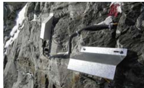
Gut gegen die Elemente geschützt, messen die Sensoren am Matterhorn Temperaturprofile und Bewegungen.
